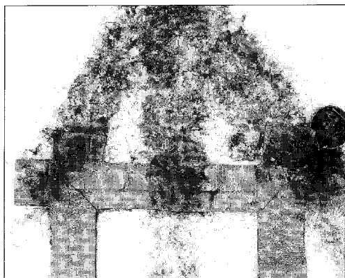
[사진 7] 열화로 가루 상태로 된 번두부 劣化で粉狀になった幡頭部
